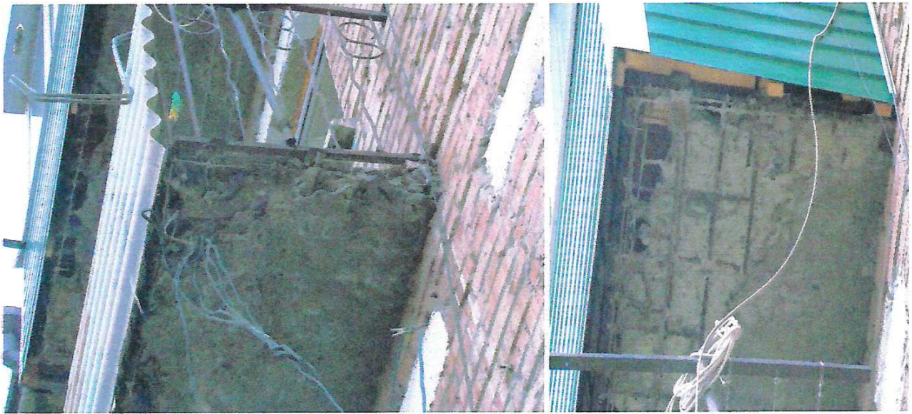
Фото №4. Дефекты балконов. Частично разрушена плита, оголение арматуры.
