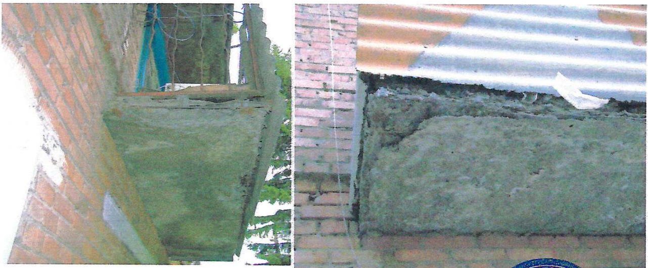
Фото №3. Дефекты балконов. Частично разрушена плита, оголение арматуры.
