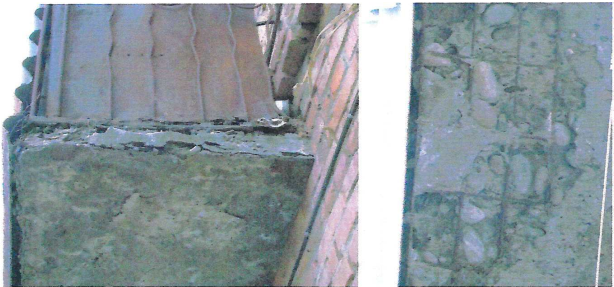
Фото №5. Износ балконов. Частично разрушена плита, оголение арматуры, снижение несущей способности.
